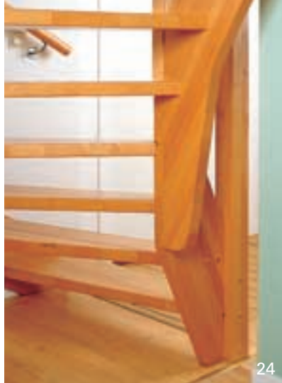
De inderste vanger er tappet sammen, hvilket giver en stabil og fristående konstruktion.
